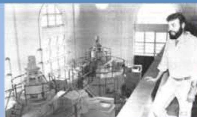
Generadores para rato El capataz Rodolfo Segundo revisa los dos generadores mejorados en la planta hidroeléctrica de Gatún, donde tres unidades más serán remozadas en el verano y la sexta en 1994.
